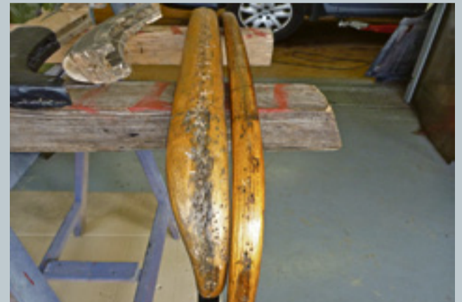
4 Die Holzträger müssen teils ersetzt, sicher aber abgeschliffen und neu lackiert werden.
