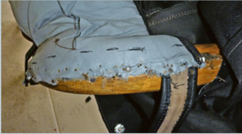
1 Ausgefranste Unterpolsterung, zerschlissene Gurten und ein Holzrahmen, der dringend eine Überholung nötig hat.
